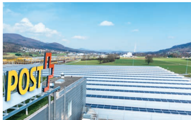
Die Post erzeugt in ihren Fotovoltaikanlagen Solarstrom für den Eigenbedarf. Der Überschuss wird ins öffentliche Netz eingespeist.
